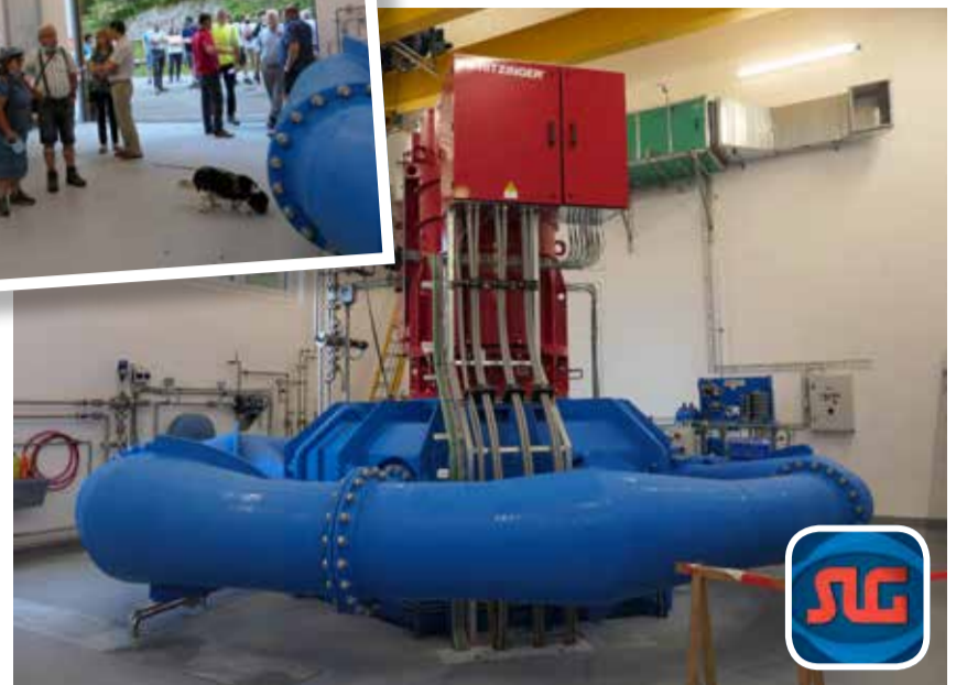
Das Interesse an ihr war gross: Die neue Pelton turbine der Firma Troyer aus Sterzing (Südtirol) im neuen Gebäude in Merlen.
